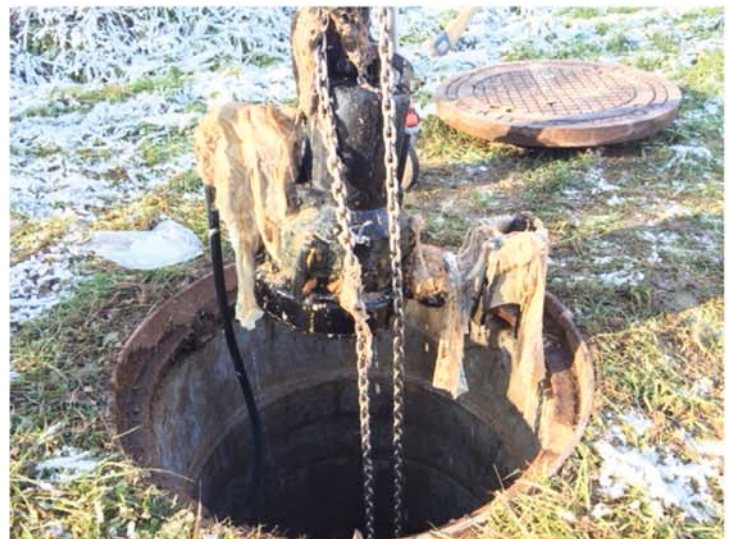
Foto: ABA Magdalensberg, durch Textilien verstopfte u. verdreckte Abwasserpumpe
